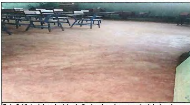
Foto 5: Vista del suelo del aula 2, piso de color concreto deteriorado volviendose una superficie irregular.
