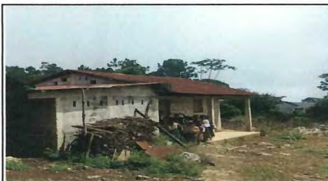
Foto 3: Aula existente debido al tiempo presenta daños los cuales se reforzaran complementando la infraestructura y reforzando las paredes del aula.
