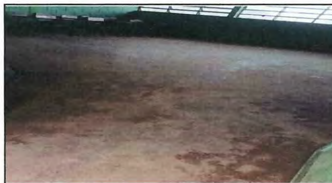
Foto 4: Vista del suelo aula 1, piso de color concreto deteriorado volviendose una superficie irregular.
