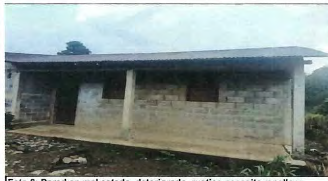
Foto 6: Pared en mal estado, deteriorado, rustico necesita repello y mejora.
