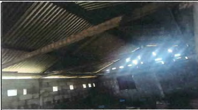
Foto 1: Cambio del techo del aula, lamina agujerada filtracion de agua por todo el lugar.
